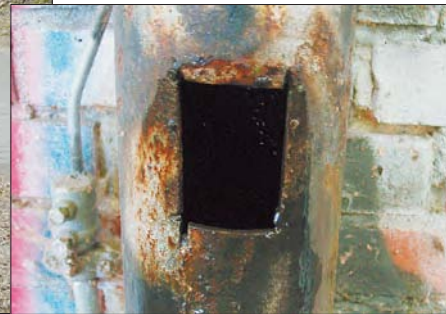
Ursache: Das Loch im Fallrohr.
